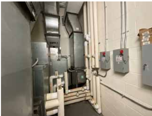
29 - FAN COIL ROOM
